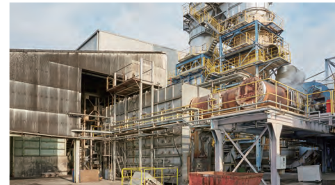
多段式焼却炉 能力：72t/日
